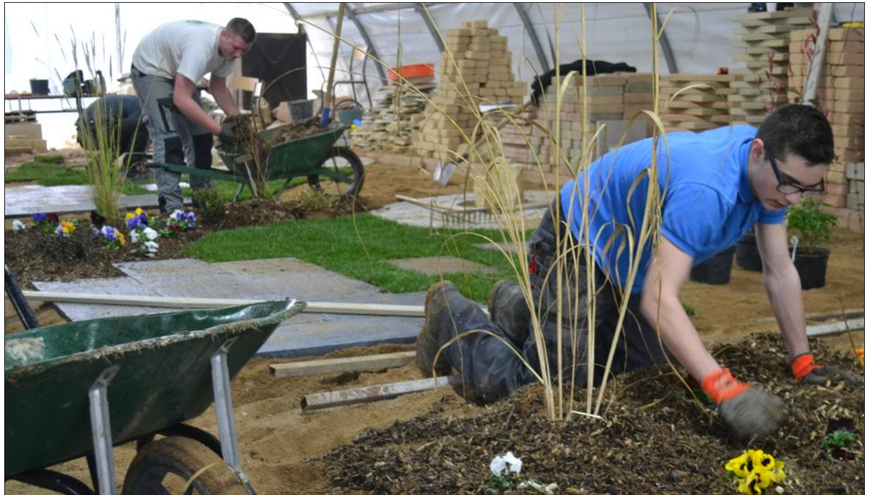
■ Les apprentis ont eu six heures pour maçonner, planter et terrasser. Photo Thomas BORJON
