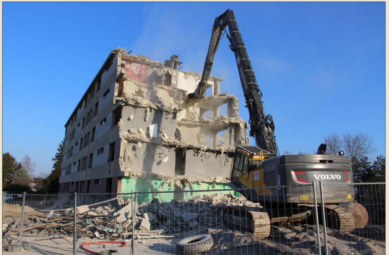
■ En 2014, les entrées du bâtiment avaient été murées en attendant la destruction. Photo Thomas BORJON
